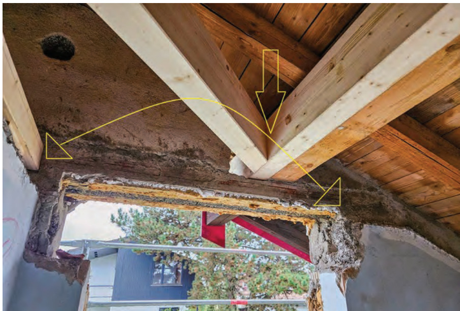
14 | Einzellasten auf Ziegelstürzen sind nicht möglich bzw. führen zu Risschäden, da sich Gewölbe nicht ausbilden kann; gezeigt an einem Beispiel.
