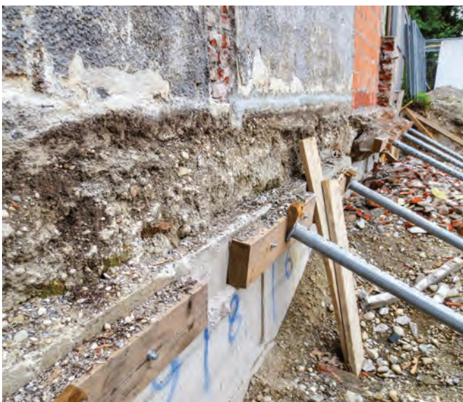
9 | In diesem Fall ist kein Streifenfundament vorhanden, sondern nur loser Kies.
