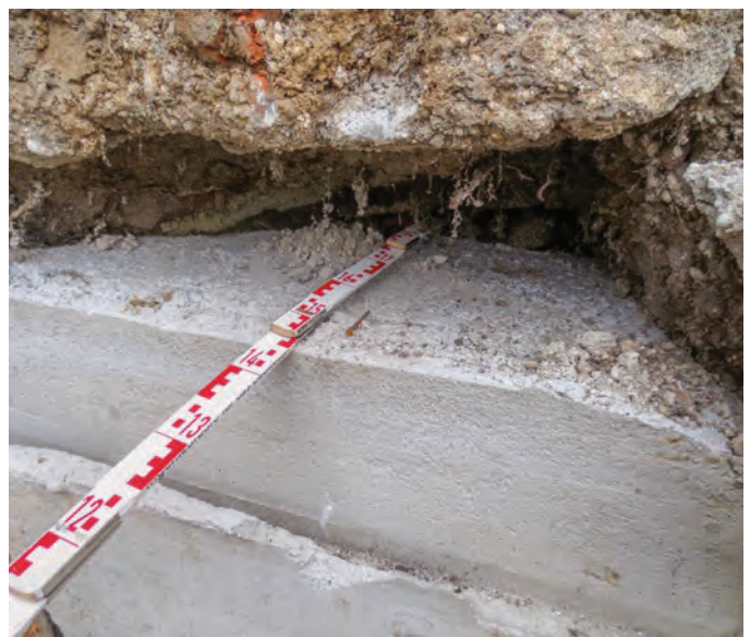
10 | Wie vorhergehend: Hohllage, kein Kraftschluss möglich
