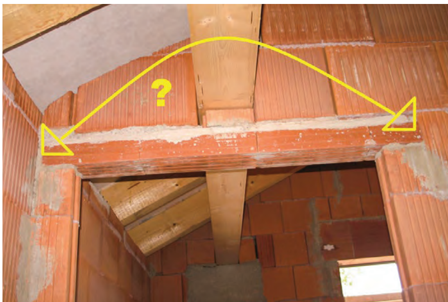
15 | Ebenso wie in Abb. 14 zeigt sich hier ein zukünftiges Schadenbild.
